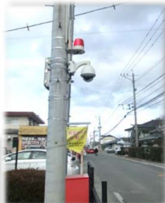
道路に面した防犯カメラ
